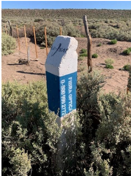
Registro Fotográfico: Mojón de Fibra Óptica.
