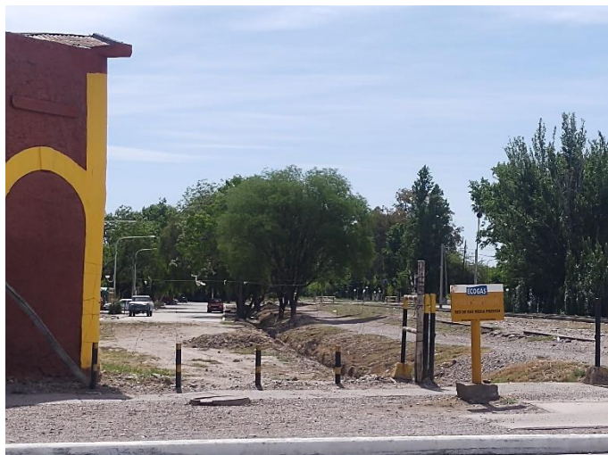
Registro Fotográfico: Intersección calle La Colonia y San Juan.
