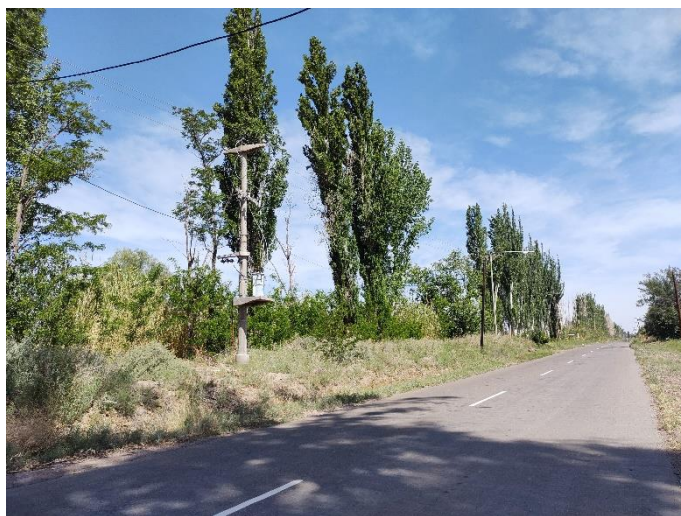
Registro Fotográfico: Calle San Juan, tendido eléctrico.
