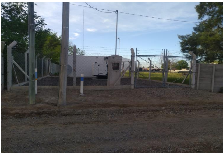
Registro Fotográfico: Ubicación del Shelter Río Colorado
