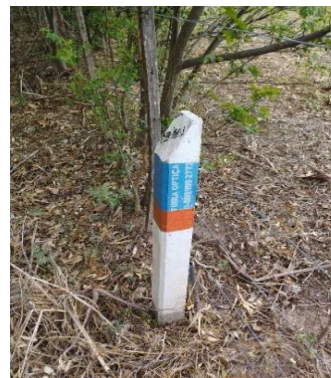
Registro Fotográfico: Mojón de punto de Interconexión.
