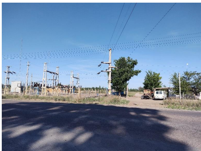
Registro Fotográfico: Inicio de traza. Estación transformadora.
