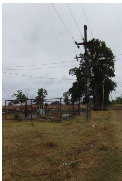
Registro Fotográfico: Transformador
