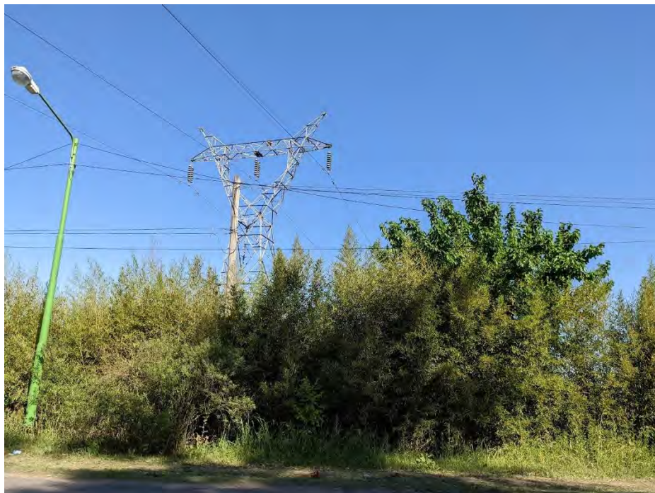
Registro Fotográfico: Cruce de Línea de Alta Tensión sobre Av. Libertador San Martín (altura progresiva ~2.500 metros de la traza)
