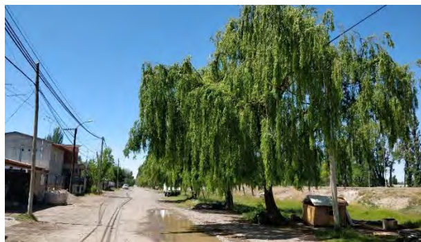
Registro Fotográfico: Poste y tendido del ramal principal REFEFO.
