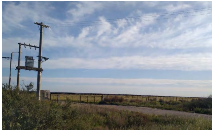
Registro Fotográfico: Tendido eléctrico
