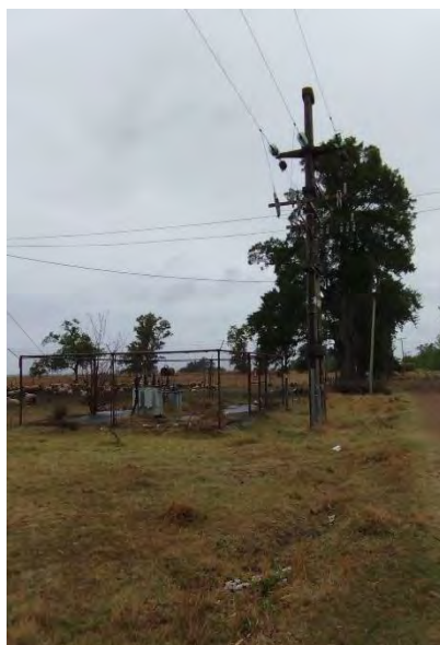
Registro Fotográfico: Transformador
