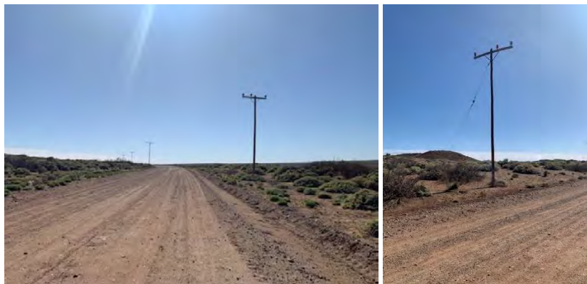
Registro Fotográfico: Cruce de línea eléctrica.
