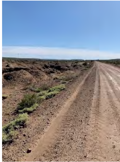
Registro Fotográfico: Banquina reducida
