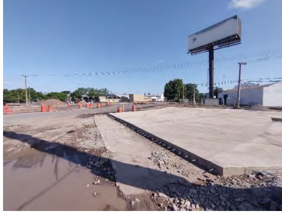
Registro Fotográfico: Inicio de traza, rotonda RP 2 y Av. Carranza. En obra.
